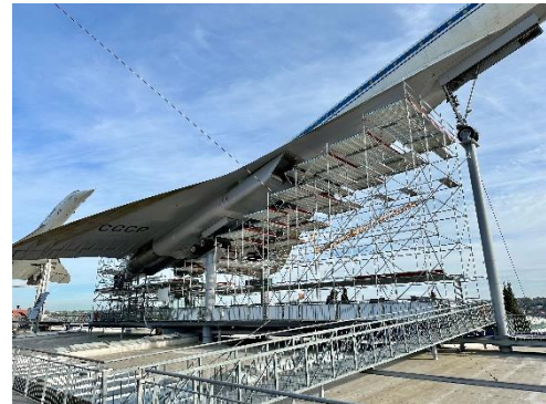
Das Gerüst passt sich präzise den Umrissen des Flugzeugs an und verfügt über moderne Absturzsicherungen. Quelle TMSNHSP.
