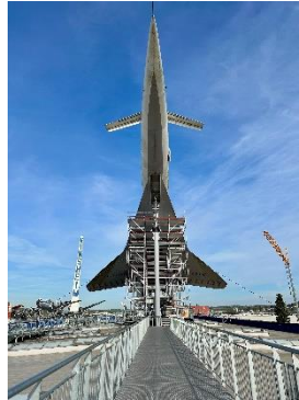
Das Gerüst wird vom Firmenmitglied Wilhelm Layher GmbH & Co. KG bereitgestellt, den Aufbau der passgenauen Konstruktion übernimmt das ebenfalls beteiligte Firmenmitglied Wolfgang Fuchs GmbH aus Bühlertann. Quelle TMSNHSP.
